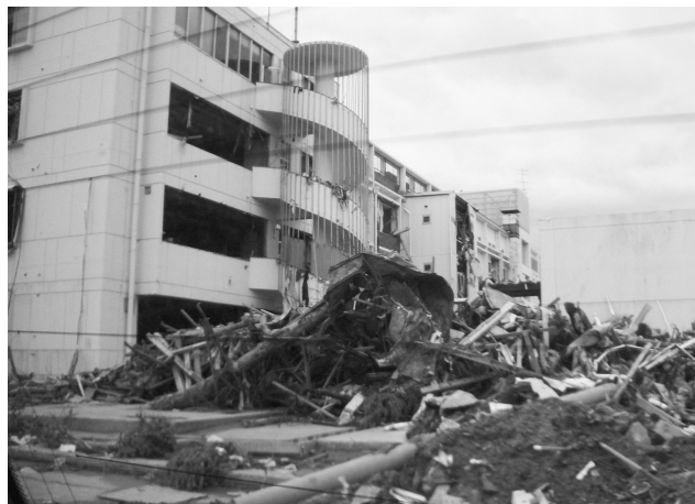
陸前高田市役所の裏手（4月撮影） 陸前高田市協職員でらせん階段を使って屋上まで避難して助かった者がいる。なお、水は屋上近くまできたとのこと。
